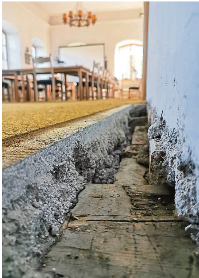
Umfangreiche Sanierungsmaßnahmen stehen im historischen Saal des Schlosses an. Zu sehen ist auf unserem Foto die Proben-Entnahme für das Statik-Gutachten.
